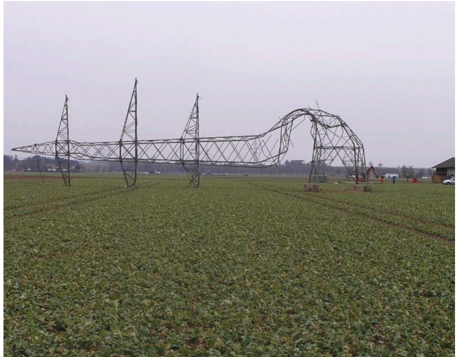
Die Argumente des Verbundes für eine Freileitung geraten nicht nur durch Sturm „Emma“ ins Wanken
